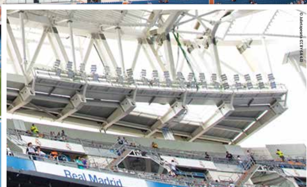
Structure de profilés creux et ponts d'éclairage sécurisés par des crapauds Type AAF
